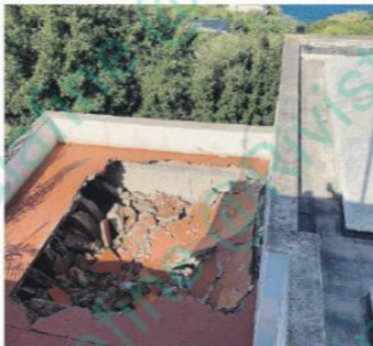
L'angolo della scuola in cui è avvenuto il cedimento
